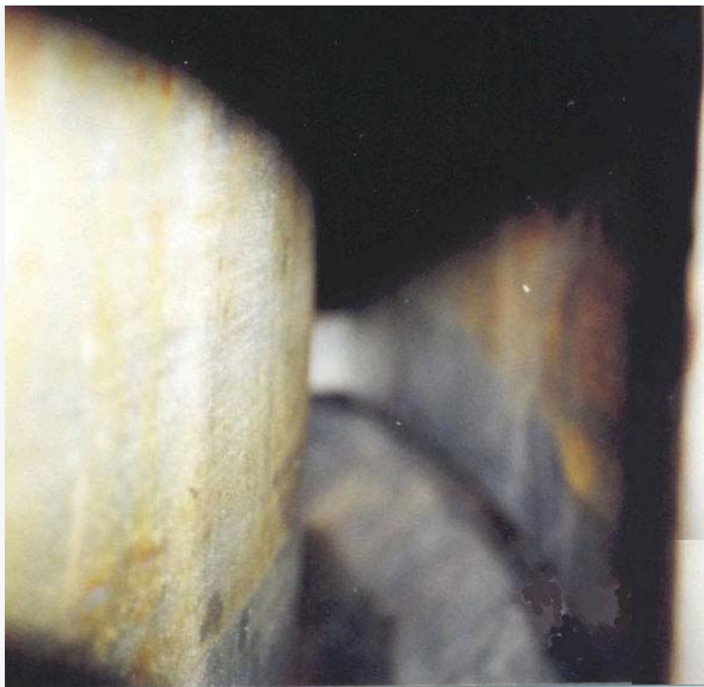
Рис. 4. Внутренняя поверхность рубашки охлаждения, видимая через люк контроля качества промывки, после промывки оборудования от накипно-коррозионных отложений
