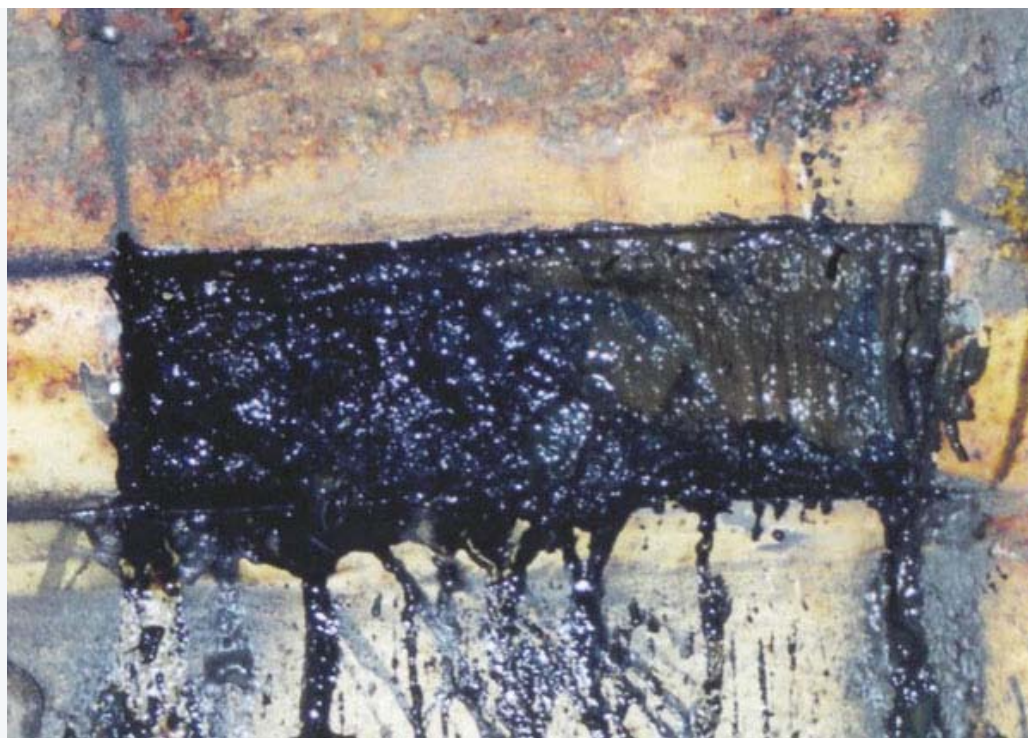
Рис. 3. Увеличенный фрагмент выреза в рубашке охлаждения акратофора (люка контроля качества промывки) до начала промывки оборудования
